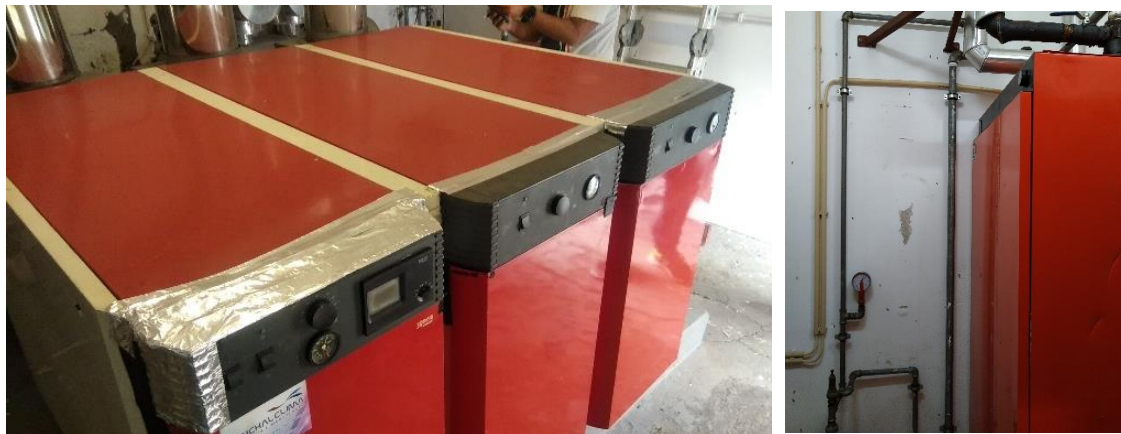
Figura 16 - Caldeira a gás e termoacumulador do lar.
