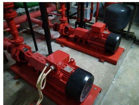
Figura 8 - Bombas de emergência.
