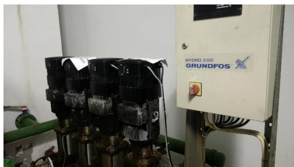
Figura 9 - Bombas de circulação.
