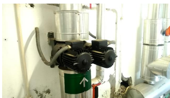
Figura 10 - Bombas de circulação à saída das caldeiras.
