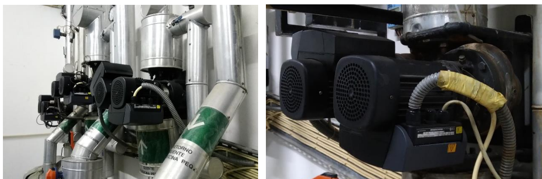
Figura 6 - Conjuntos de bombas de circulação.
